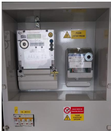
Obrázek 1:26 Elektroměrový rozváděč s přijímačem HDO
