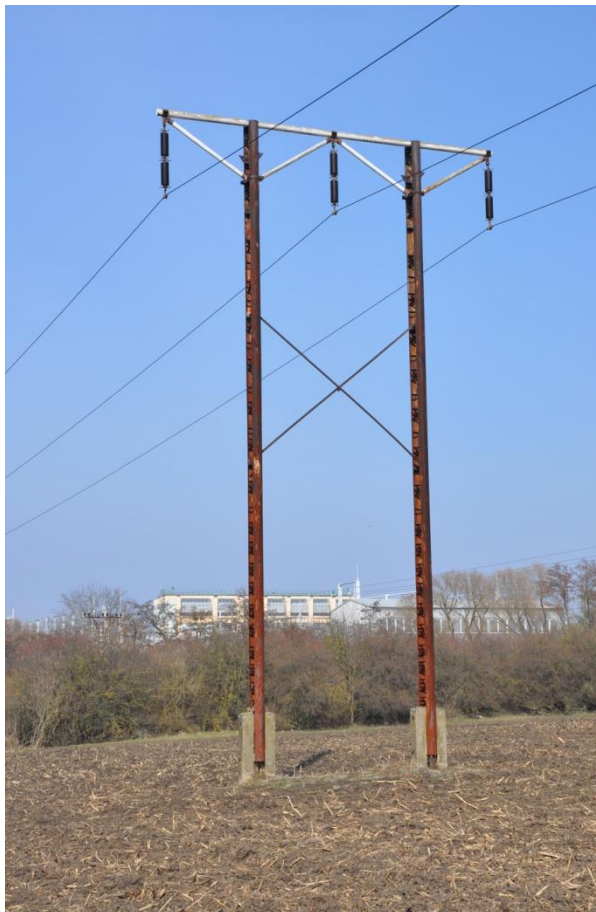
Obrázek 2:53 Venkovního vedení 110 kV (stožár typu SEDLÁK)
