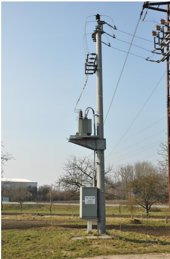
Obrázek 2:50 Sloupová trafostanice 22/0,4 kV
