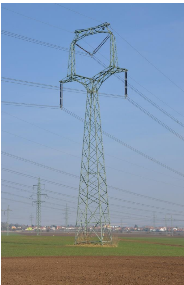
Obrázek 2:66 Vedení ZVN 400 kV (nosný stožár typu DELTA)
