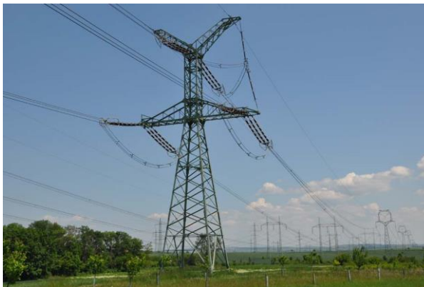
Obrázek 2:64 Vedení ZVN 400 kV (výstužný stožár typu KOČKA)
