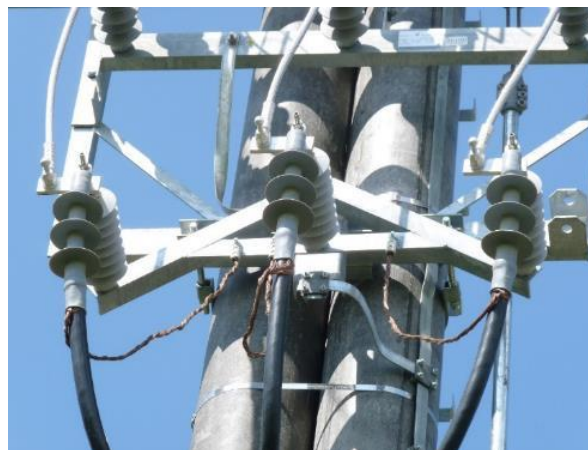
Obrázek 2:97 Omezovače přepětí a kabelosvod VN
