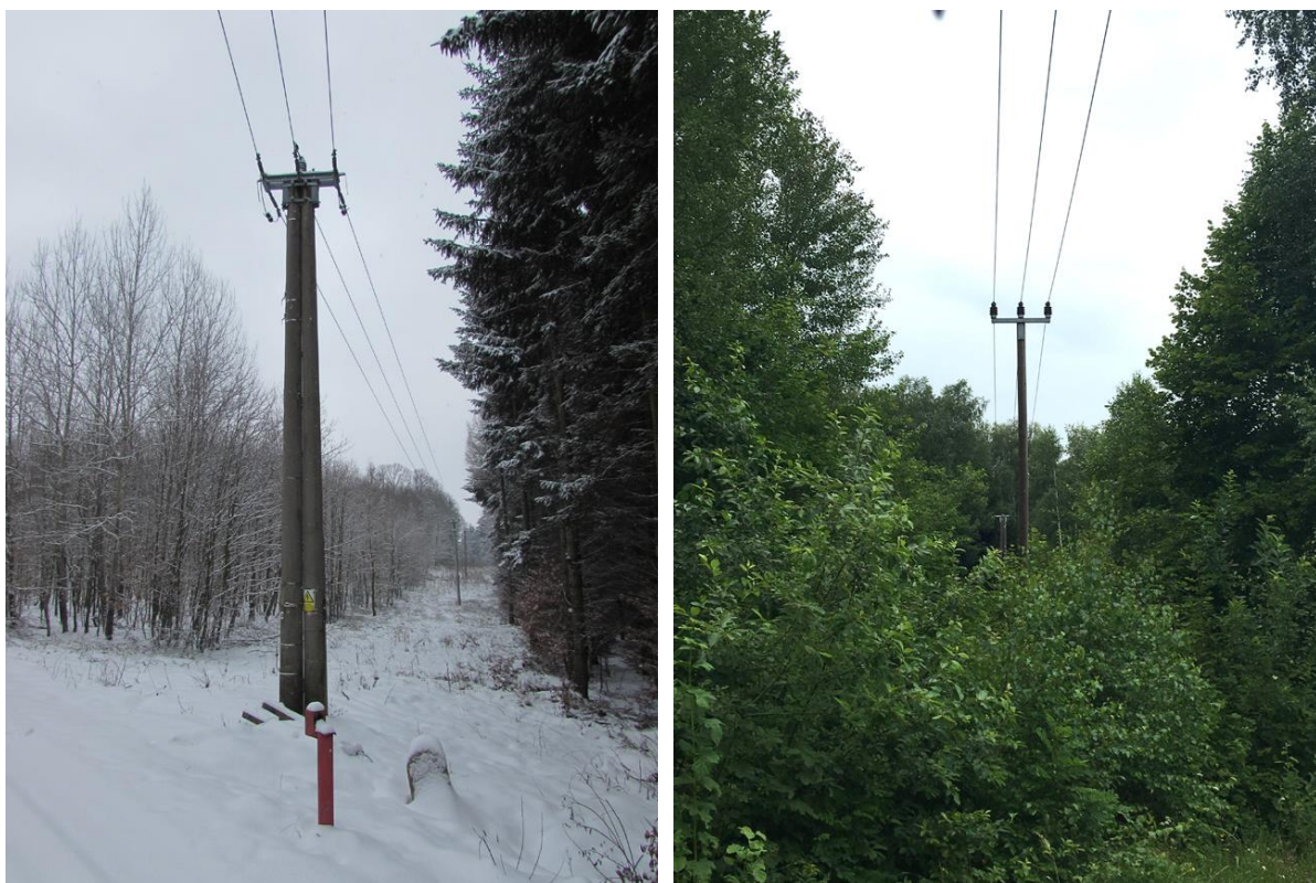
Obrázek 2:38 Izolované vedení VN umístěné v lesním porostu
