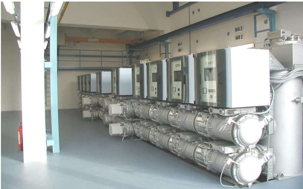
Obrázek 2:59 Zapouzdřená rozvodna 110 kV
