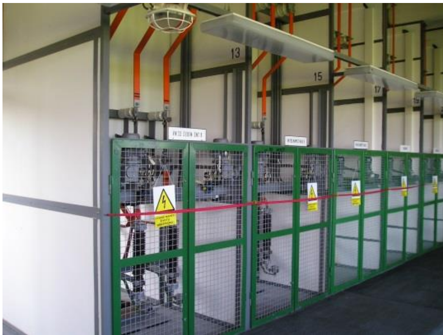
Obrázek 2:49 Kobková rozvodna 22 kV
