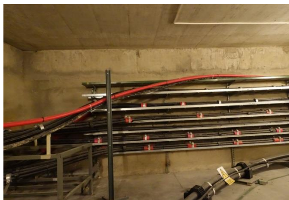
Obrázek 2:47 Kabelový prostor rozvodny před vstupem do kolektoru
