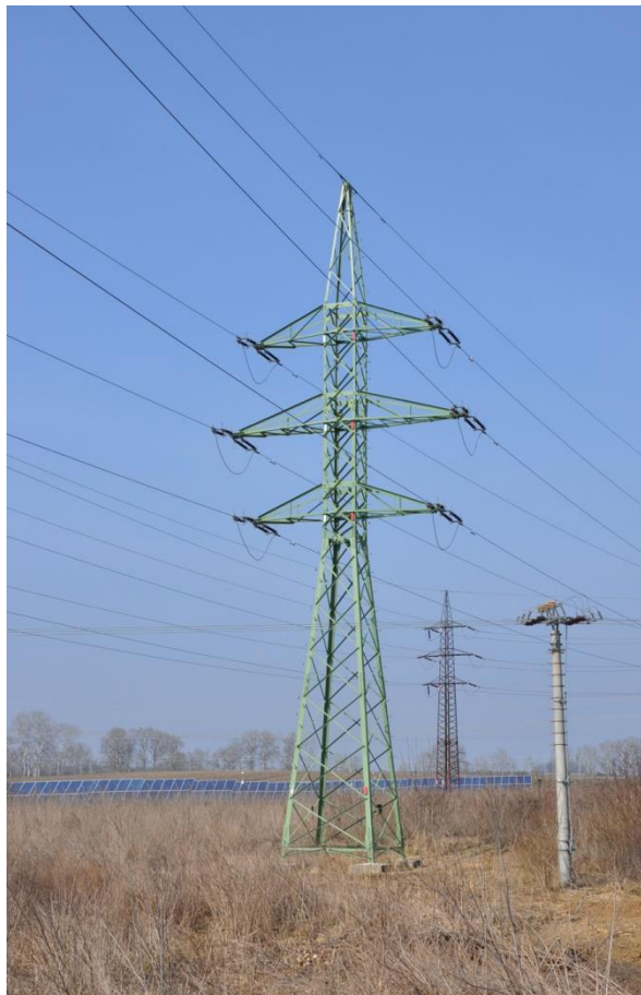
Obrázek 2:54 Venkovního vedení 110 kV (stožár typu SOUDEK)
