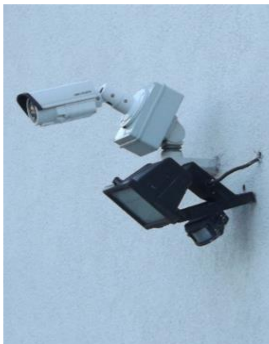
Obrázek 3:56 Osvětlení budovy a kamerový systém
