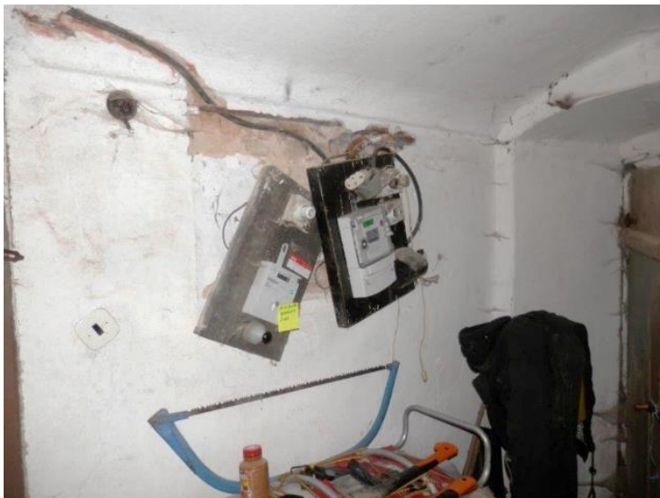
Obrázek 3:88 Dezolátní stav instalace
