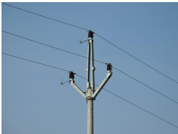
Obrázek 2:96 Ochranné jiskřiště na vedení s holými vodiči
