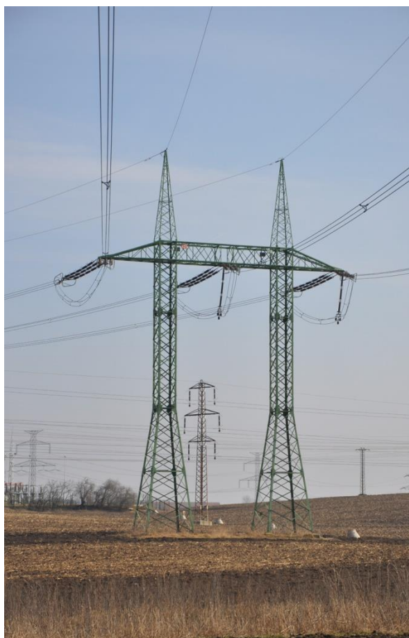
Obrázek 2:67 Vedení ZVN 400 kV (stožár typu PORTÁL)
