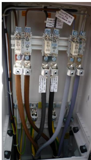
Obrázek 1:25 Připojení odběrného místa ze smyčkovací přípojkové skříně SS 200
