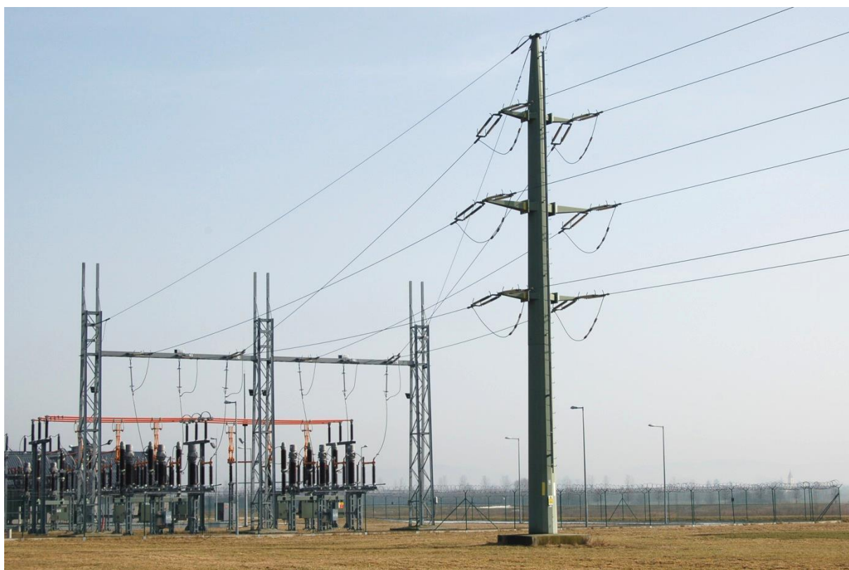
Obrázek 2:55 Vývod z rozvodny a ohraňovaný stožár 110 kV
