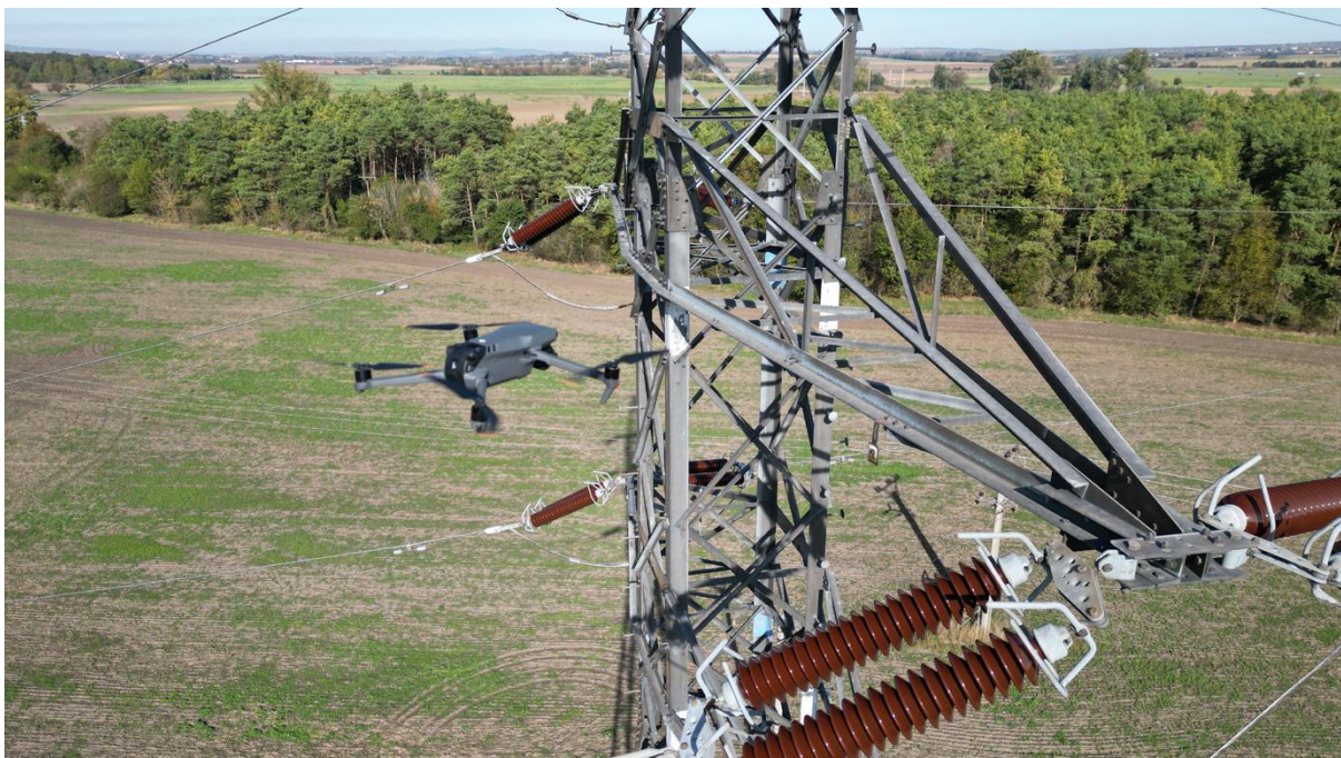
Obrázek 3:94 Použití dronu při kontrole vedení 110 kV
