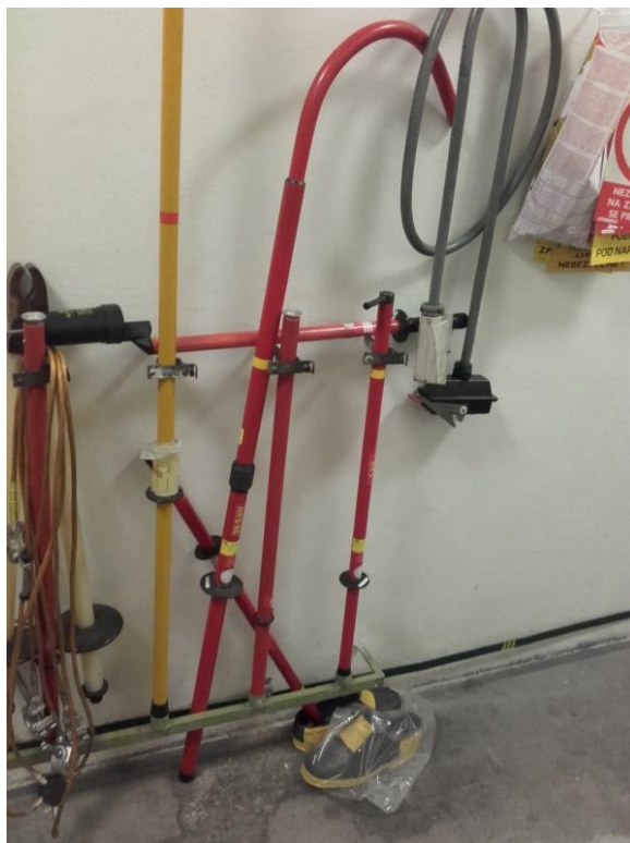
Obrázek 4:22 Ochranné pomůcky v elektrické stanici
