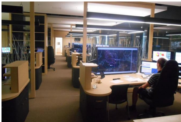
Obrázek 3:4 Dispečerský sál Dispečinku 22 kV Brno
