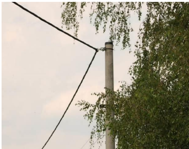
Obrázek 2:27 Izolované vedení NN na betonovém sloupu
