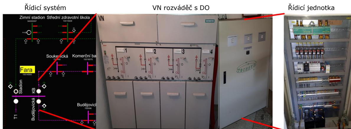
Obrázek 3:26 Dálkově ovládaná trafostanice
