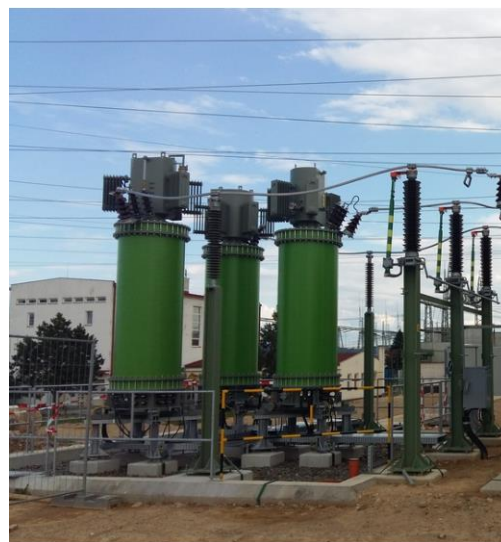
Obrázek 2:78 Vazební transformátor 110kV jako zdroj signálu HDO 14
