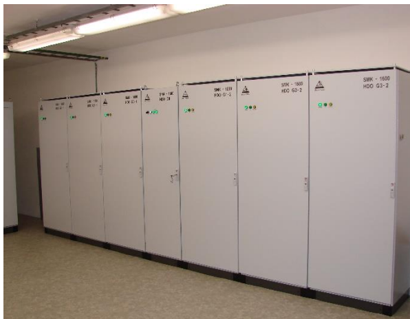
Obrázek 3:36 Vysílač HDO 110kV — sestava rozvaděčů SMK 1600, HDO1 + HDO2
