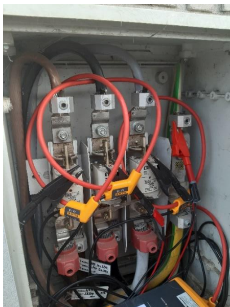
Obrázek 3:99 Měření kvality elektrické energie
