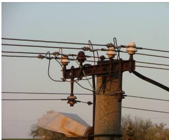
Obrázek 2:26 Holé vedení na betonovém sloupu
