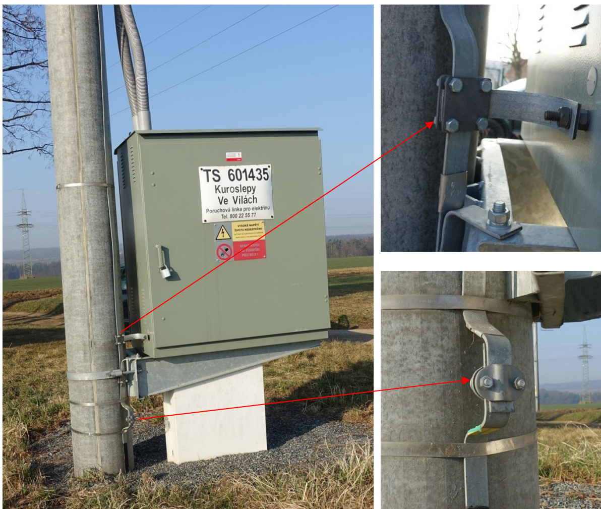
Obrázek 2:92 Uzemnění kovové skříně rozváděče a zkušební svorka sloupové trafostanice
