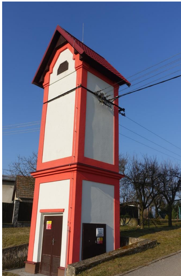
Obrázek 2:51 Věžová trafostanice 22/0,4 kV
