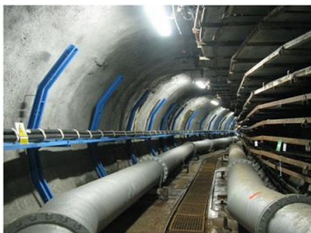
Obrázek 2:58 Uložení kabelového vedení 110 kV v primárním kolektoru
